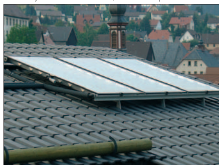
Kolektory słoneczne na dachu, centrala ciepła w domu.
